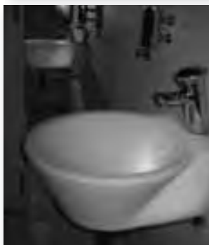
Le Pavillon de l'eau à Paris dispose de lavabos situés à la sortie du WC avec un porte-savon à proximité et une robinetterie facile à manipuler.
